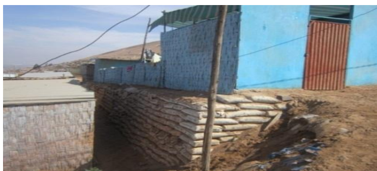
Imagen 87 Asentamiento humano donde se evidencia la construcción en forma empírica y vulnerable ante eventos sísmicos
